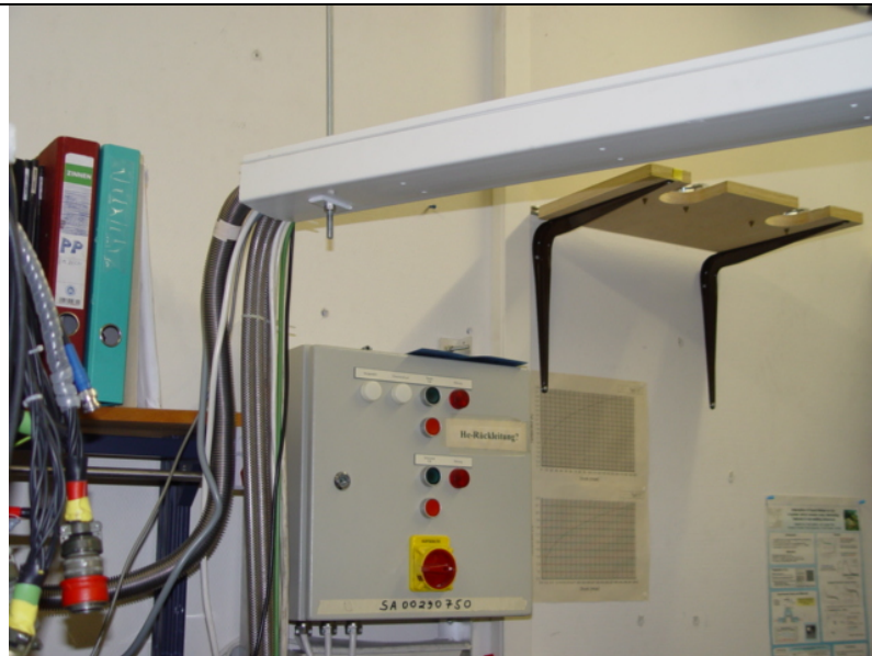
Geordnete Kabelverlegung mit Fixierung. Oberhalb des Verkehrsbereiches – ohne Stolperstellen
