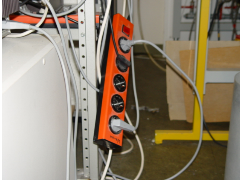
Ungeordnete Kabelverlegung mit hängender Steckdosenleiste
